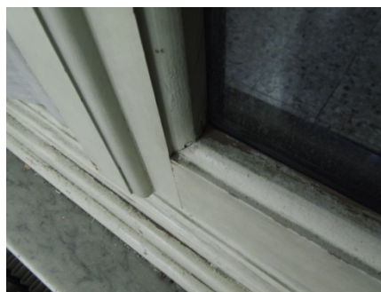
Figura 8.1 - Particolare serramenti da sostituire.
