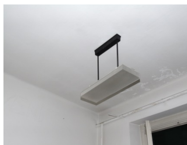
Figura 8.7 - Particolare impianto illuminazione su cui intervenire.
